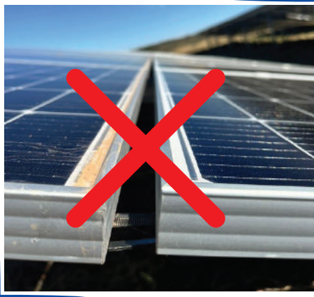
*Klemlerin tork kontrolleri yapılmadığı için paneller arası boşluk mesafesi artmış durumda
