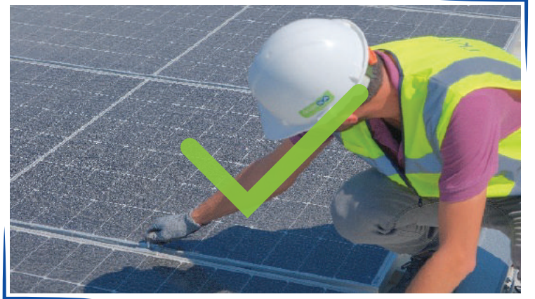
*Paneller arası açıklıkların artmaması için tork kontrolleri yapılarak bu sorunun önüne geçilmektedir.
